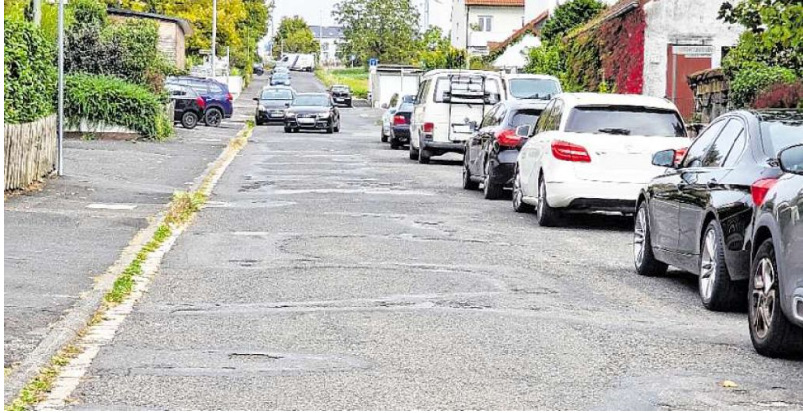
Seit Jahren eine Buckelpiste: 2024 soll die Sanierung der 1300 Meter langen Lindentalstraße in Veitshöchheim in zwölf Bauabschnitten beginnen. Foto: Dieter Gürz
